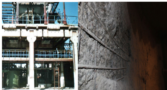
Рис. 1 – Разрушение поверхностного слоя бетонной конструкции насосной станции
